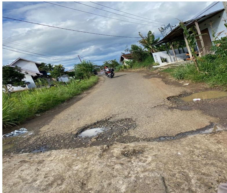
Gambar 4. 1 Jalan Yang Berlubang
