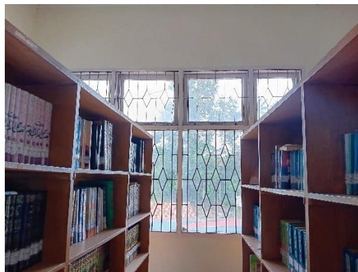
Gambar 4.6 Penggunaan Ventilasi pada Ruang Perpustakaan
