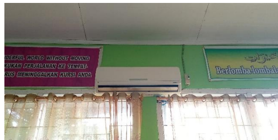
Gambar 4. 6 Pendingin Ruangan (AC) yang rusak
